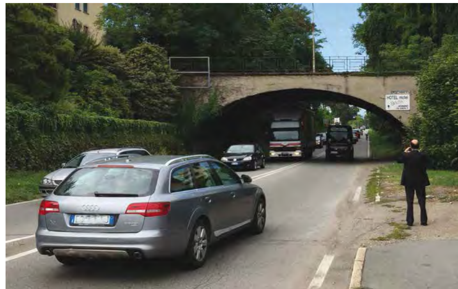
2. Ponte in mattoni e cemento armato di via per Castellanza, nel comune di Legnano
